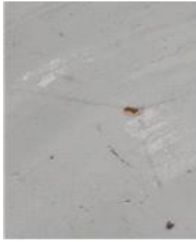
<참고5. 결손과 균열>
